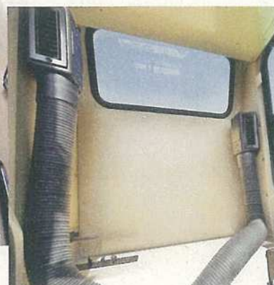
▲エアコンダクト
